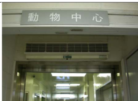
動物中心入口處裝設風簾乙阻止蚊蟲隨人員進入設施內
